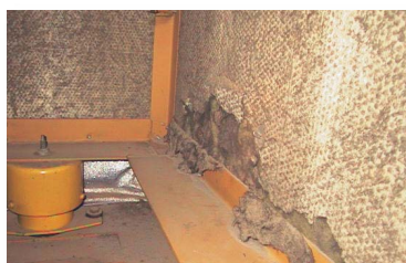
ファン室機内断熱材剥離のため (要整備)
