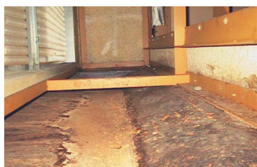
ドレンパン発錆のため (要整備)
