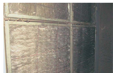
プレフィルタ劣化がひどく (要更新)
