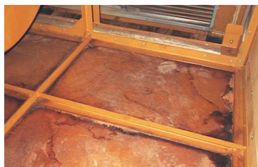
ファン室機内汚れのため (要整備)
