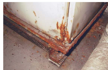
外板下部錆のため (要整備)
