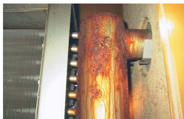
ヘッド部分に錆がひどく (要更新)
