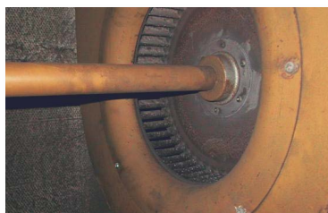
粉塵付着とファンハウジングの錆のため (要整備)
